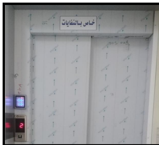
Figure N°33 : ascenseur pour transport des Déchets
